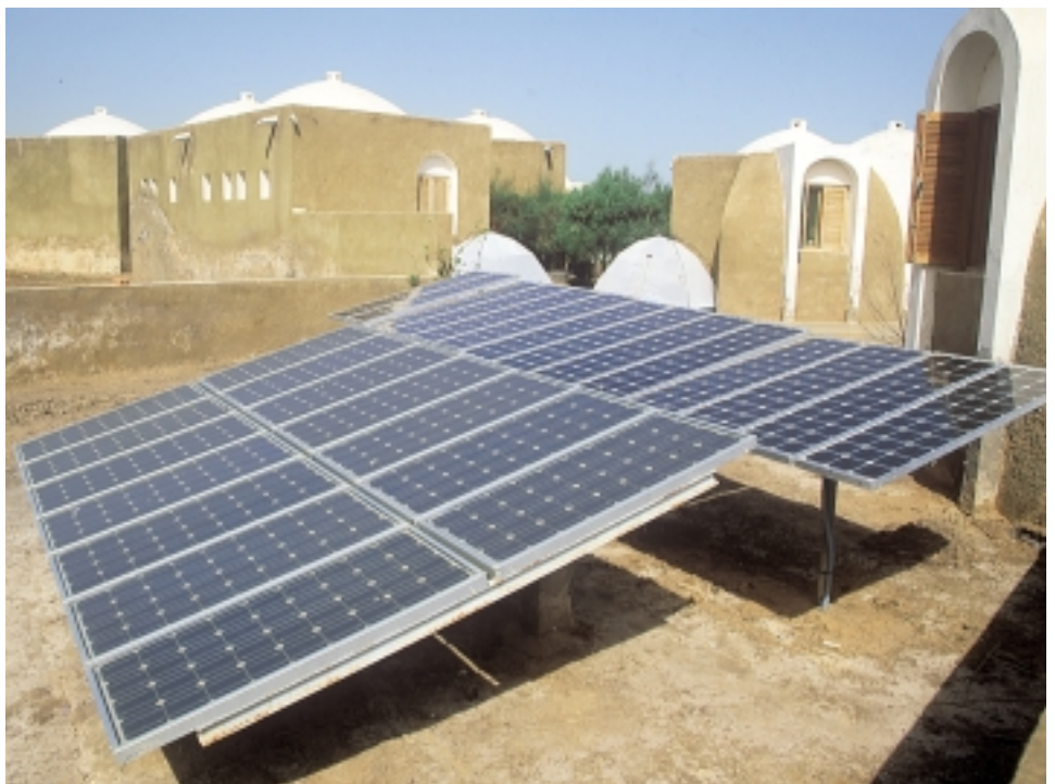
Die Stromversorgung der Biologischen Station erfolgt vor allem über eine Solaranlage.
